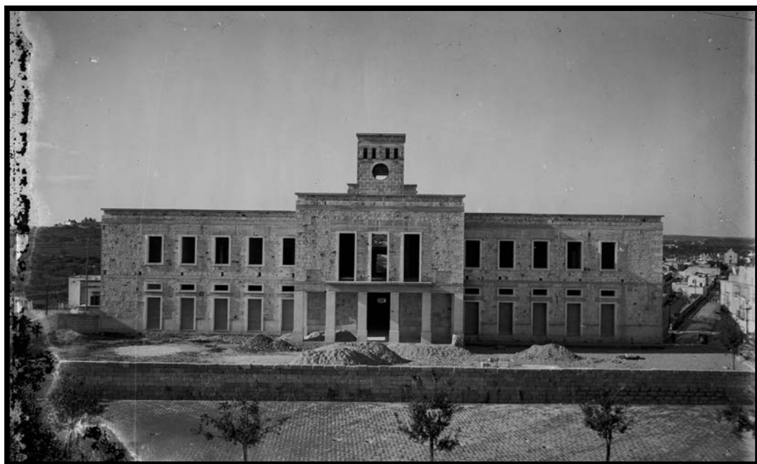
Anni '50. L'attuale edificio del Comune di Locorotondo in costruzione. Come si vede la struttura originaria è in pietra.
